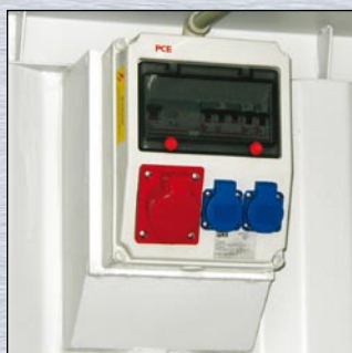
caja de distribución con enchufes integrados
