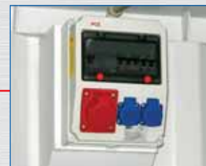
Verteilerkasten mit integrierten Steckdosen
