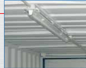
Leuchtbalken mit Feuchtraumschalter
